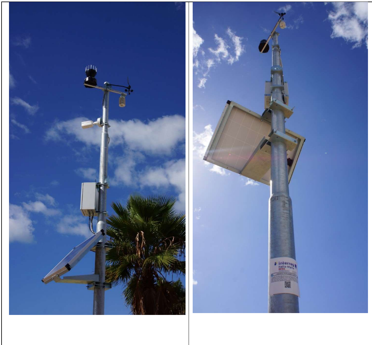
Figura 8.3. Stazione con videocamera e anemometro (Progetto BESS - INTERREG ITALIA MALTA)
